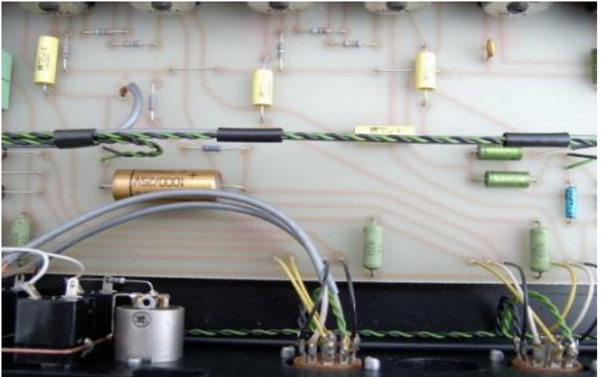
Bild 3: Innenleben, saubere ordentliche Verkabelung.
